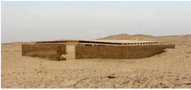
Figura 12. Vista general de la construcción del tejado y de la puerta para proteger el oratorio copto del sector 19.
